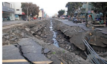
圖 7a 一心一路氣爆後災損情形（既有箱涵毀損）
