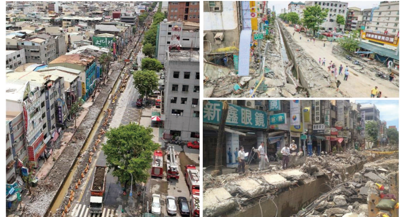
圖 3 三多路路段（武營路至凱旋路口）受損情況
