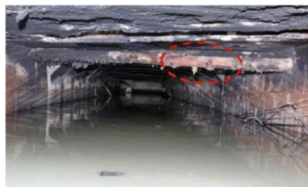
圖 2 凱旋路、二聖路箱涵內之丙烯外洩管線
