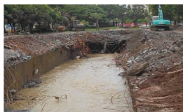
圖 7b 一心一路氣爆後災損情形（下游箱涵狀況不明）
