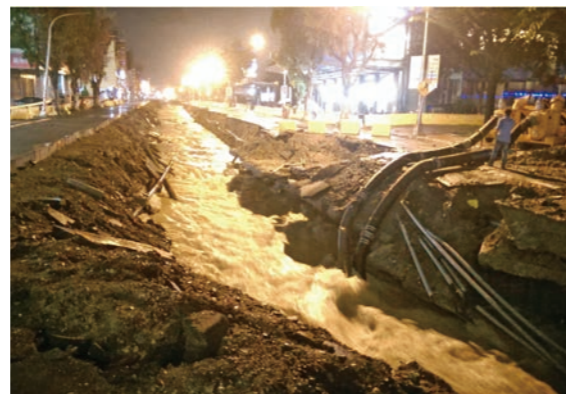
圖 8 一心一路氣爆後復建困難點（上游逕流量影響工進）
